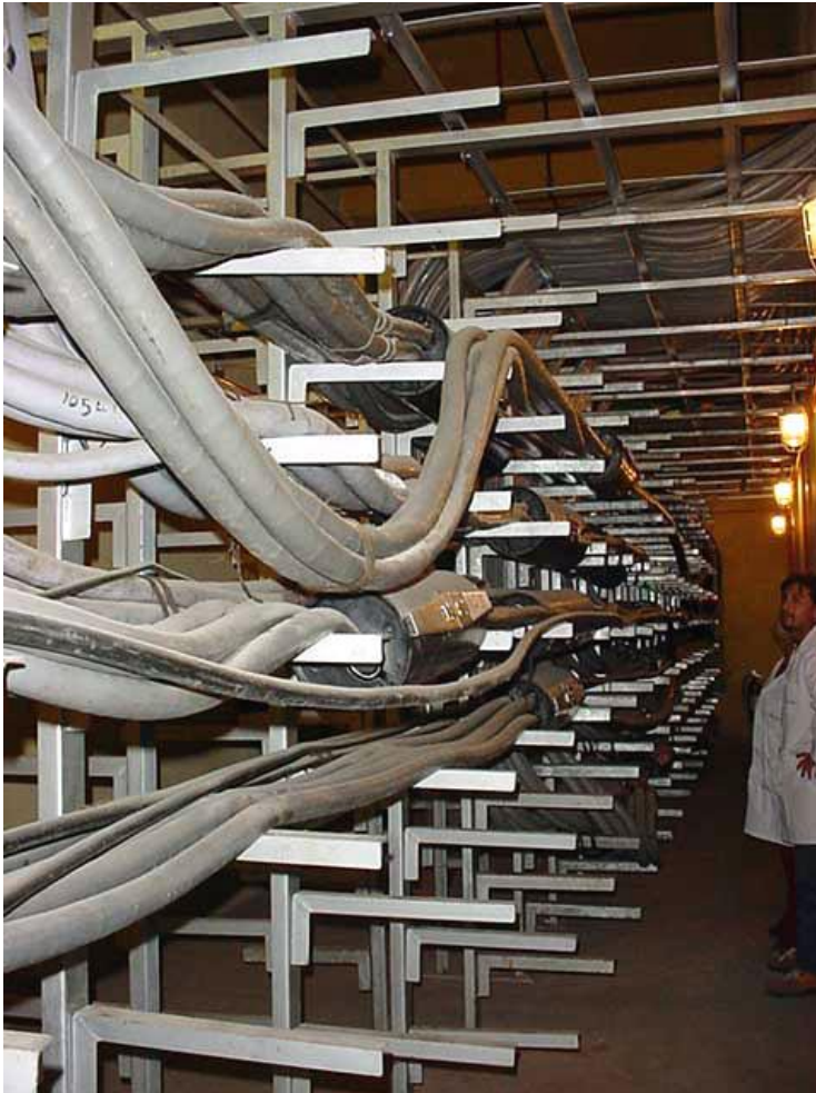
Túnel de cables
