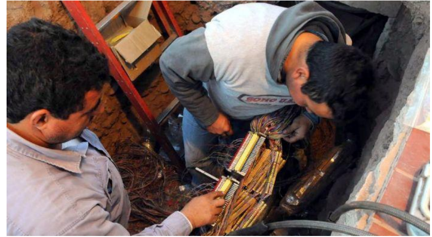
Empalme de cable multipar
