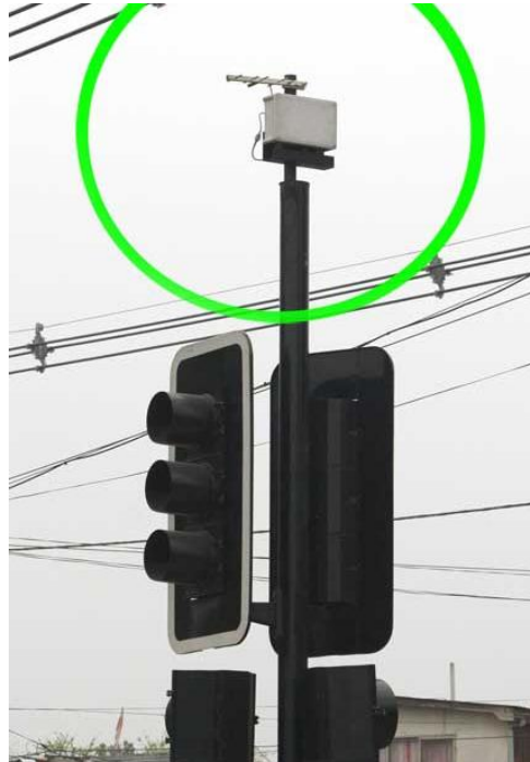
Antena yagi UHF para telecontrol de semáforos
