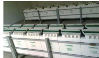
Banco de baterías
