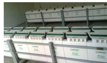
Banco de baterías
